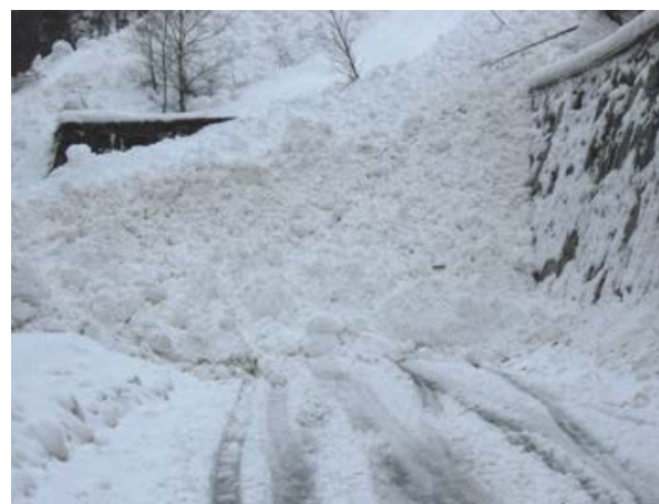
Figure 47 : Exemple de zone de dépôt bloquant l'entrée du tunnel (© Région autonome Vallée d'Aoste)
