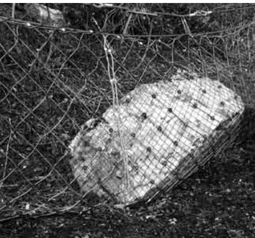
Chute de bloc.
