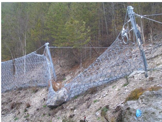
Abb. 11: Die Überwachung ist notwendig, um den Instandhaltungsbedarf zu ermitteln und damit die kontinuierliche Funktionsfähigkeit zu gewährleisten.
