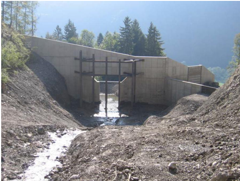
Rückhaltebecken nach Modifizierung
