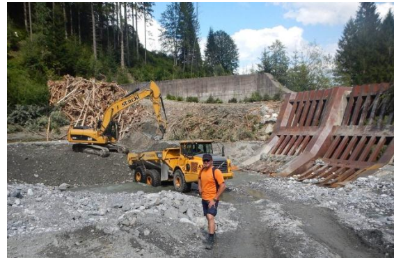
Abb. 9: Der Betrieb kann ebenfalls einen hohen Aufwand bedeuten. So müssen Rückhaltebecken zum Beispiel regelmäßig ausgeräumt werden.
