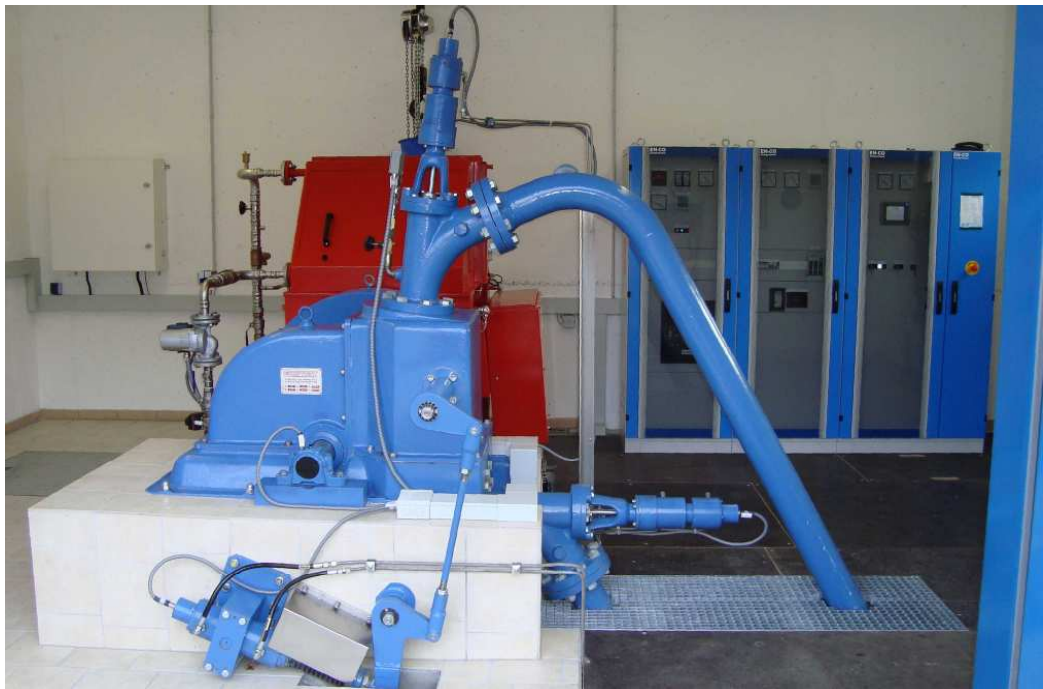
Figure 22: Pelton turbine © Gemeindewerke Garmisch-Partenkirchen
